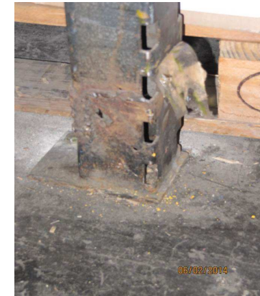
Montanti con tracce di ruggine ed elemento saldato
