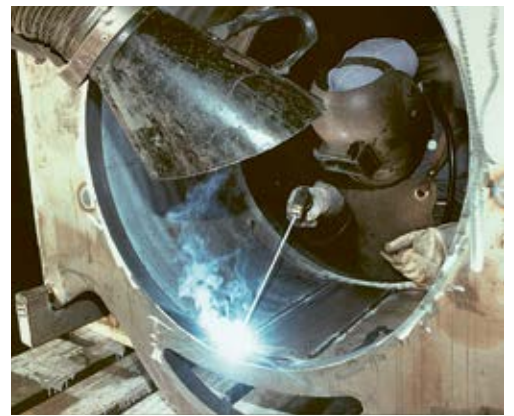
4 Cappa flessibile, a forma di coclea, per la cattura e l'aspirazione dei fumi di saldatura
