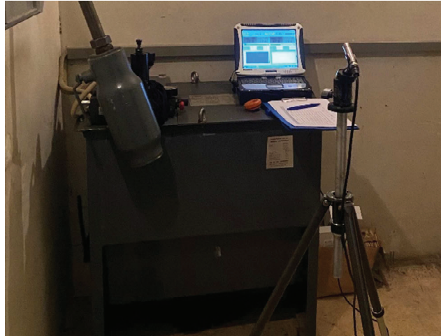
Foto 1 – Locale centralina, ascensore 2: idraulico posto al piano terra nelle vicinanze della porta ascensore
