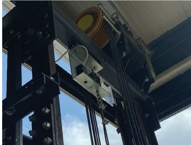
Foto 3 - Vano corsa motore, ascensore 3-gearless
