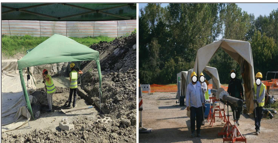
Foto 4: strutture ombreggianti versatili che possono essere facilmente movimentate in funzione dell'attività da svolgere
