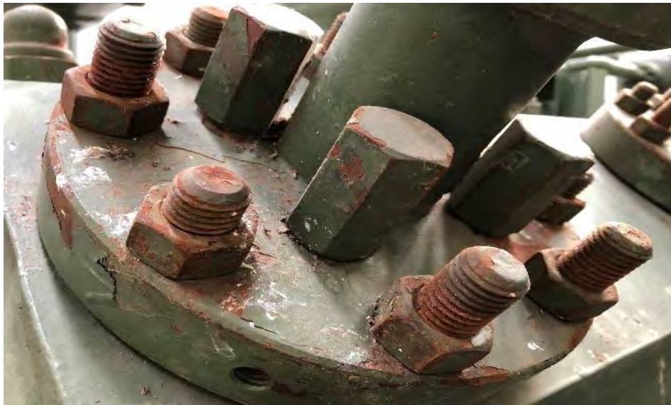
Figura 5. Tiranti e bulloneria del coperchio valvola di aspirazione su KB-11. Evidenti i segni di ossidazione.
