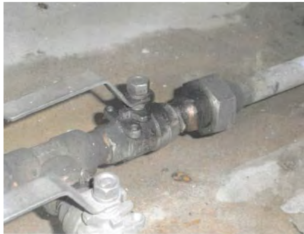
Figura 8. Difetto di installazione.
