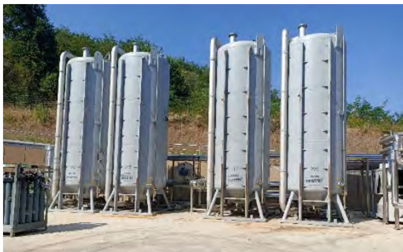
Figura 6. Filtri H 2 S e COV
