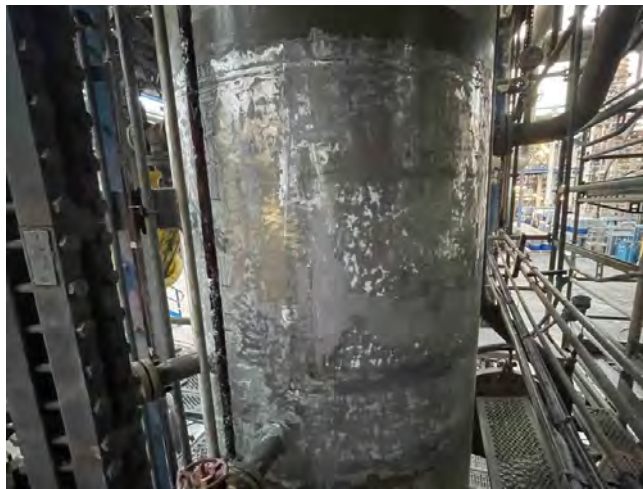
Figura 10. Apparecchiatura senza rinforzo (Archivio V.E.D. s.r.l.)
