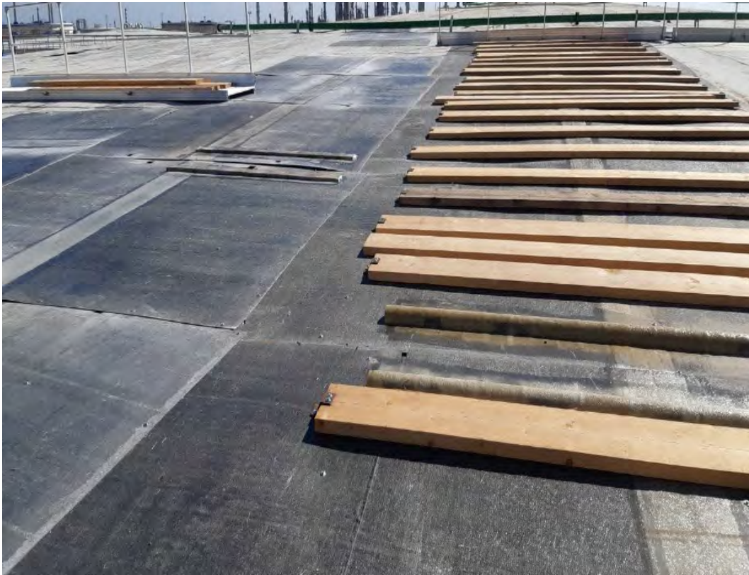
Figura 4: Esempio di riparazione di un tetto fisso di un serbatoio in acciaio tramite l'utilizzo di laminati in materiale composito.
