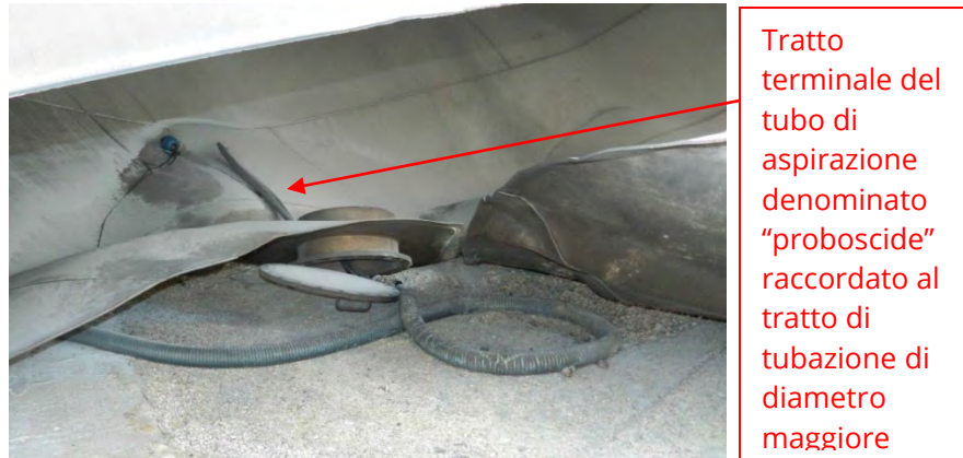
Figura 6.bis. Passo d'uomo aperto: si evince il tratto terminale del tubo di aspirazione
