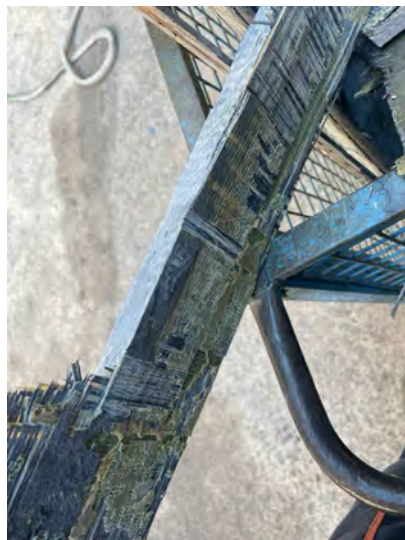
Figura 9. Parte di rinforzo rimosso (Archivio V.E.D. s.r.l.)
