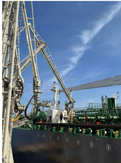
Figura 7. Fase di distacco di braccio di carico greggio da pontile n.1 (gestione LOC 2)
