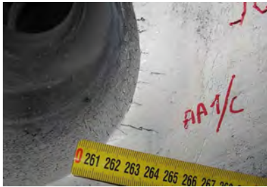
Figura 4. Esempio dei difetti riscontrati sul corpo cilindrico
