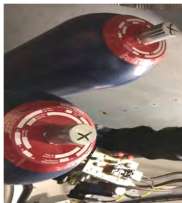
Figura 3. Fotografia di due accumulatori idraulici installati all'interno della navicella di un aerogeneratore del Parco eolico di Mazara del Vallo (prov. TP), eseguita dagli autori
