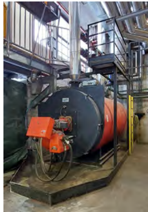
Figura 5. Caldaia a gasolio
