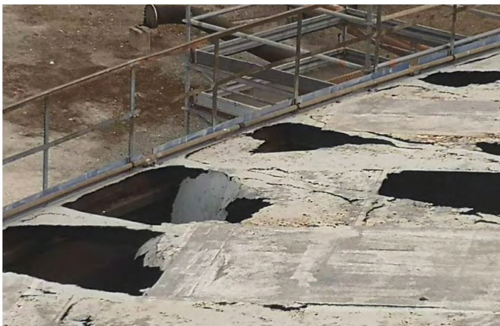
Figura 1. Esempio dell'aggressione corrosiva del fluido sulla superficie del tetto di un serbatoio.
