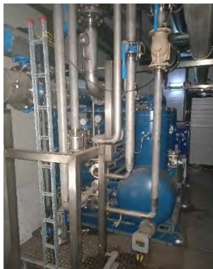
Figura 10. Impianto di compressione
