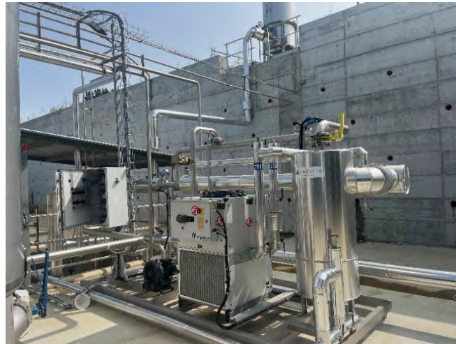
Figura 10. Impianto di purificazione
