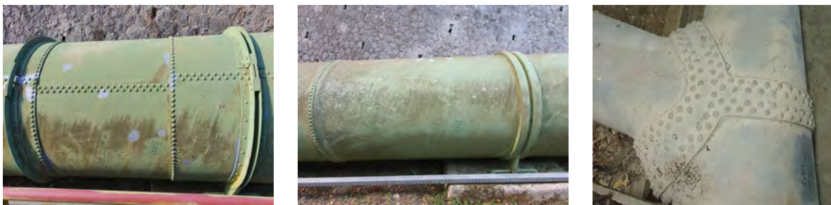
Figura 2. Tubazioni con giunti chiodati longitudinali e circonferenziali (sx), solo circonferenziali (centro) e dettaglio di stacco a tee (dx)
