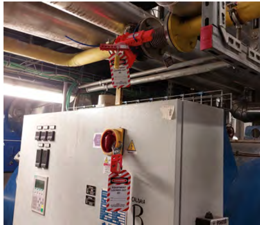
Figura 13. Lockout-Tagout del sezionatore elettrico e della valvola gas metano
