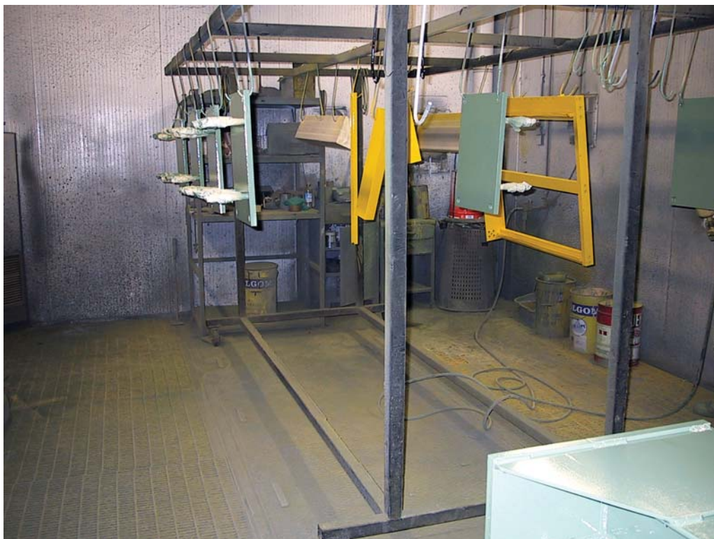
Figura 2 – Pavimento grigliato con aspirazione dal basso
