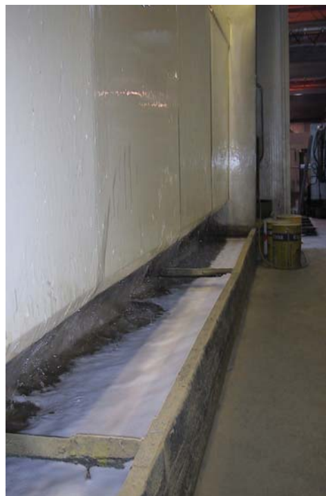
Figura 4 - Vasca di raccolta in cabina di verniciatura
