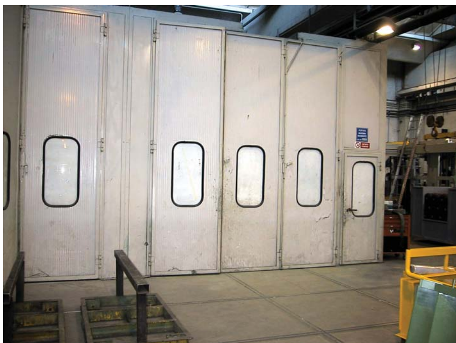
Figura 1 – Cabina di verniciatura chiusa in struttura metallica
